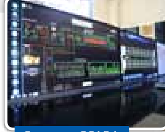
Server ve SCADA Sistemleri
